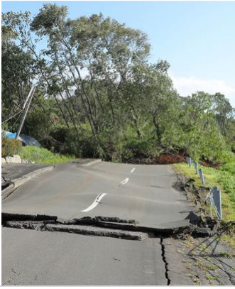
地震の影響で波打つ道路（6日＝北海道厚真町）
